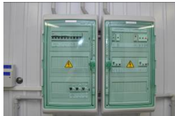
Щитки электроснабжения собственных нужд
