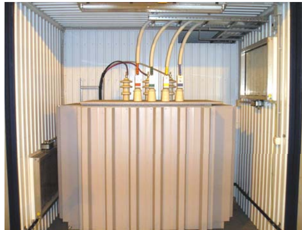
Отсек силового трансформатора с сухим трансформатором, кабельное подключение трансформатор - РУНН
