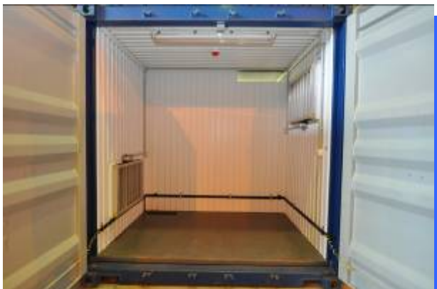
Отсек силового трансформатора
